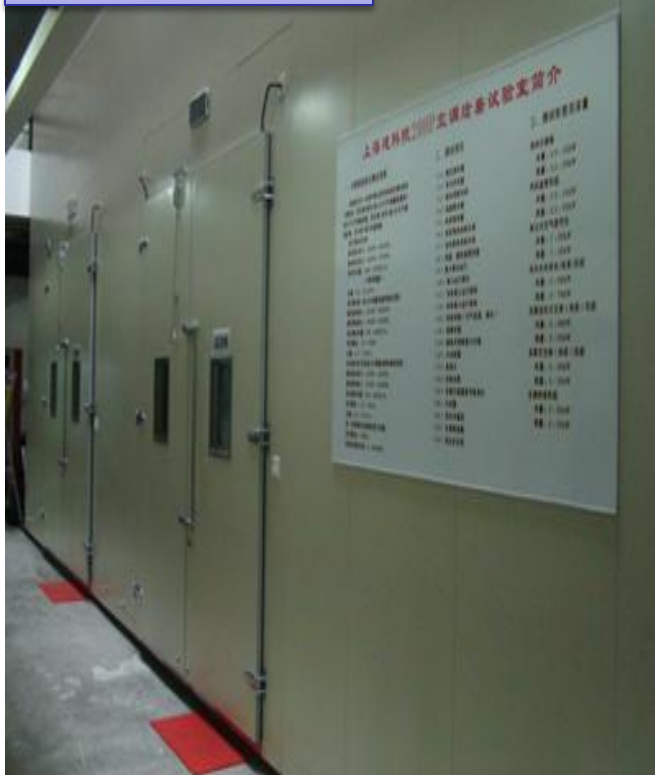
20HP空调焓差实验室
