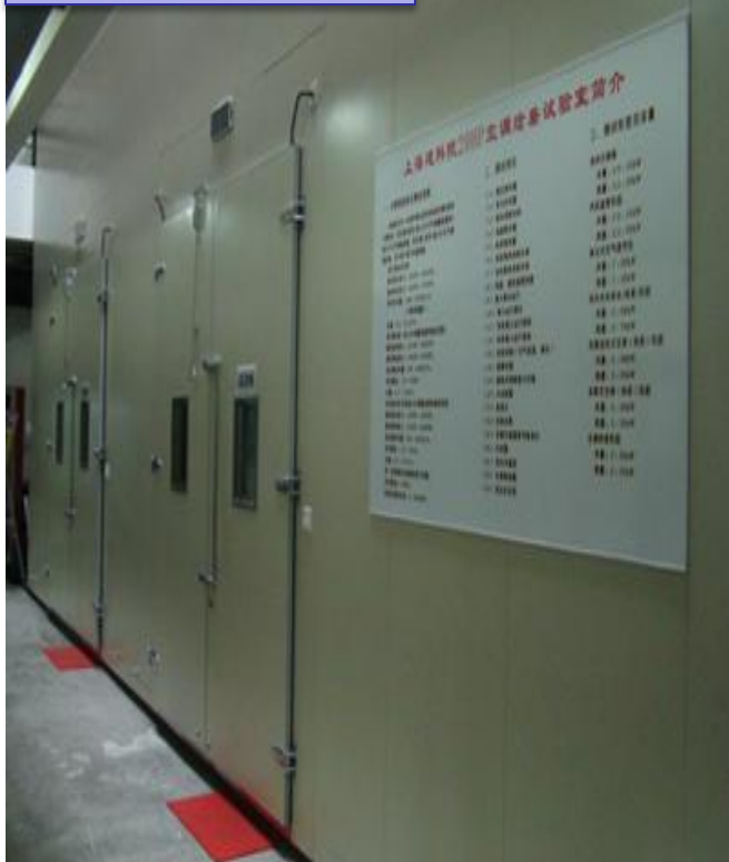
20HP空调焓差实验室
