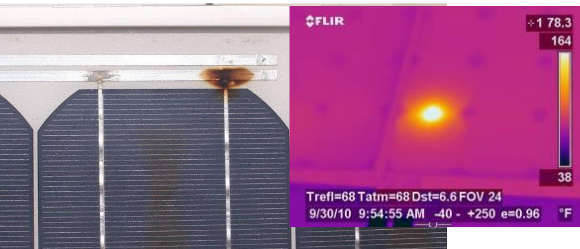
PV Module Failures
