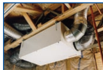
IBACOS, NREL / PIX12910
