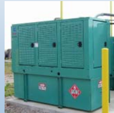
Onan 125kW Generator
